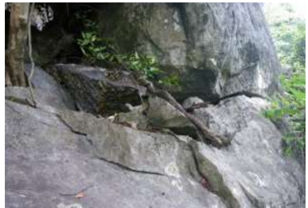
Registro fotográfico de fratura decorrente de evento recente, provavelmente decorrente da operação de lavra
