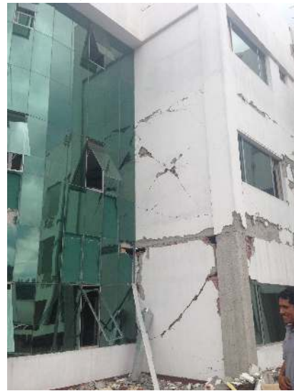
(d) Muisne earthquake inter-storey drift failure, Ecuador (EERI, 2018)
