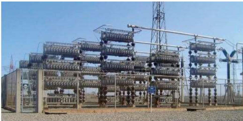
Figura 10 - Banco de capacitores usados em SE.
