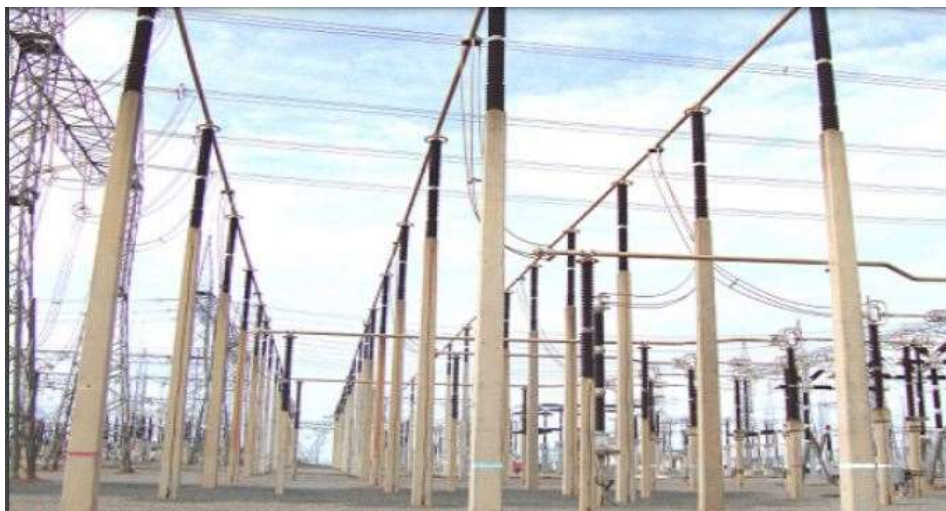
Figura 4 - Subestação de alta tensão.
