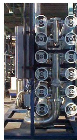
Figura 4. Instalación de ósmosis inversa.
