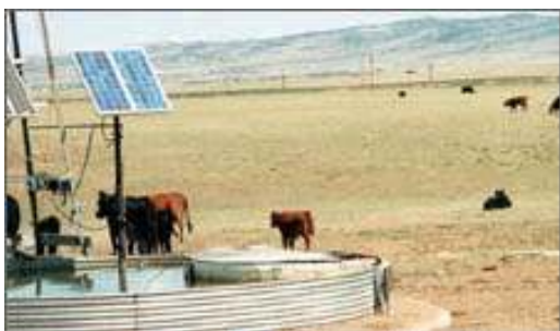
Figura 3.4 Sistema para bombeamento de água.
