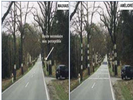
Figure 6 : Route secondaire non perceptible assez tôt : freinage inattendu et vitesse trop élevée en ce point causent des accidents [21]
