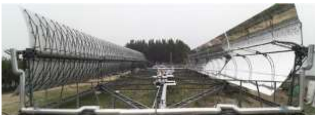
Fig. 5 Parabolic trough field [28].
