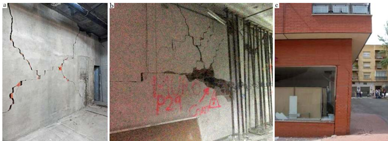
Figura 5. Daño no estructural en tabiquería (DS2 o DS3): por fisuración diagonal (a) y por deslizamiento (b); y mecanismo de planta débil o blanda (DS4) (c).
