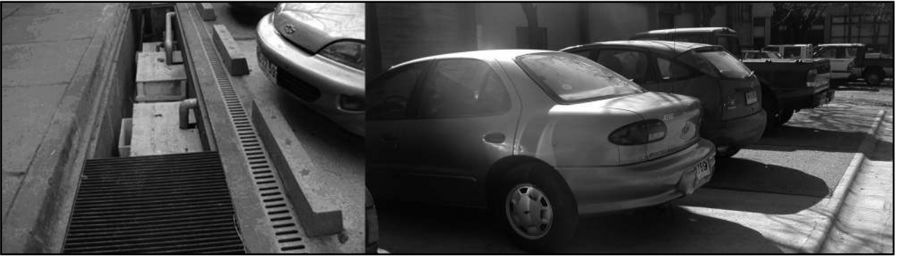
Figura 7. Instalación instrumentalizada de pavimentos porosos de hormigón. Figure 7. Porous concrete pavement test parking lot.
