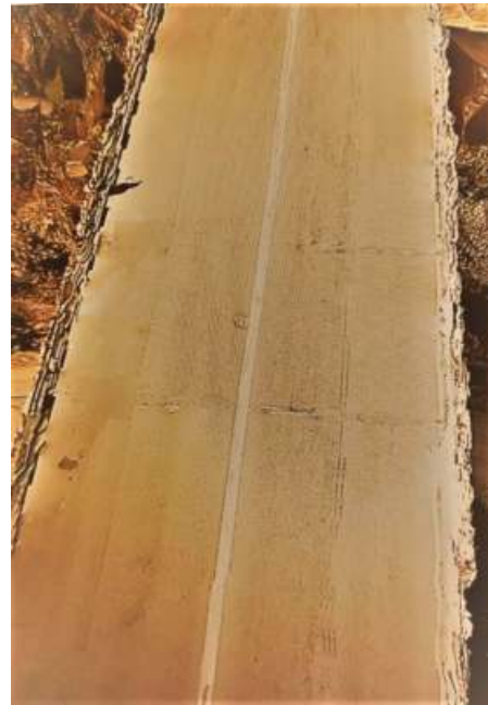
Fig. 6 - Cambio cromatico per far risaltare le difettosità all'analisi visiva (fonte: propria elaborazione)
