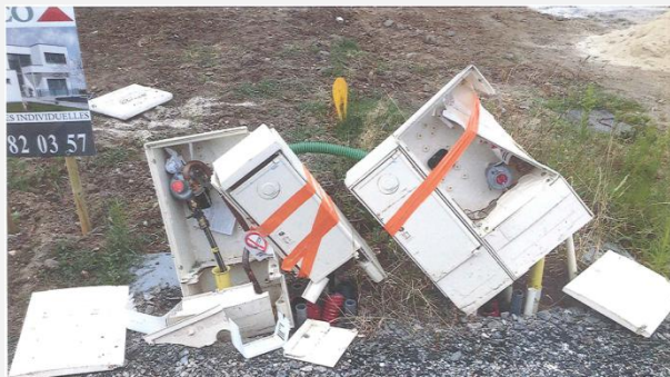
Figure 33 : Photo d'un coffret couché prise et remontée par le technicien.
