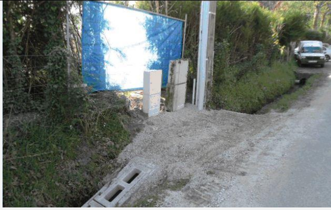
Figure 36 : Le même coffret réglé par les responsables du raccordement et envoyé au site (situations d'après).
