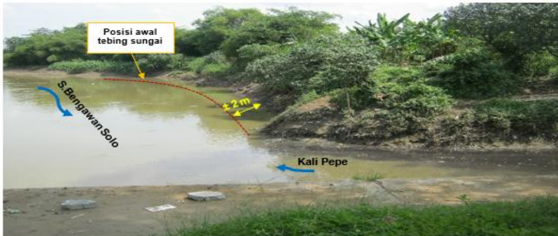
Gambar 4 Kondisi tebing kiri Sungai Bengawan Solo yang mengalami gerusan
