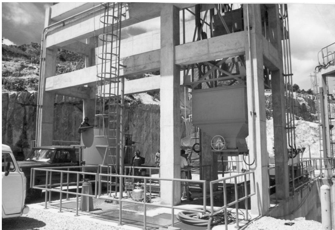
Figura 2 - Foto do mecanismo de transposição de peixes do tipo elevador com caminhão-tanque implantado junto à Usina Hidrelétrica de Santa Clara. À direita vê-se a caçamba do elevador em ascensão para deslocamento em direção ao caminhão-tanque (à esquerda).
