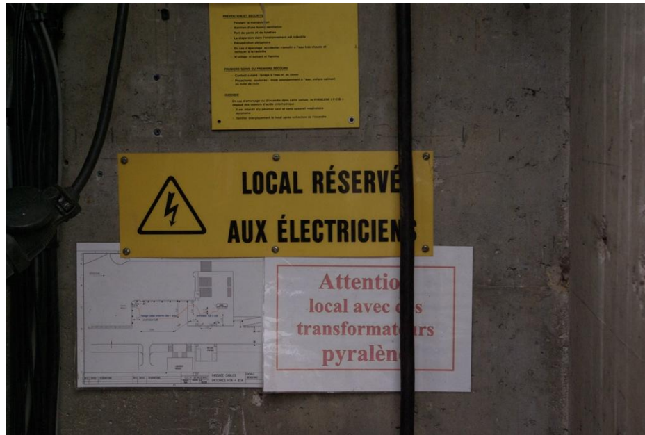
Figure 7 : Transformateur électrique contenant un mélange de PCBs (pyralène) situé sur la Dordogne au barrage de Bergerac.
