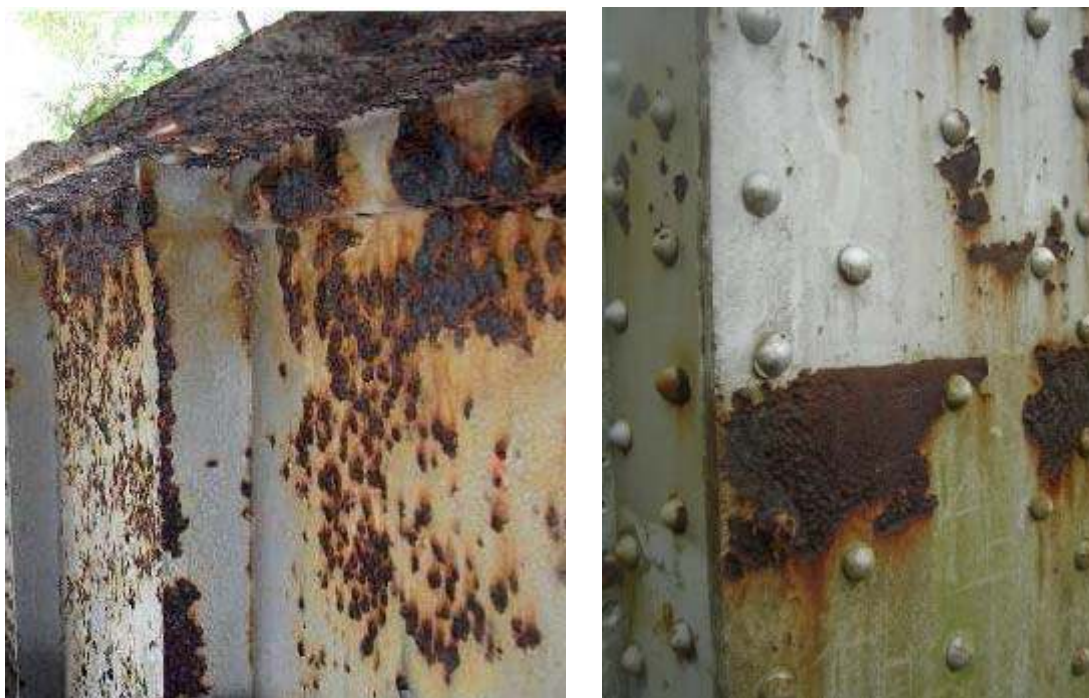
Figura 3.9: Corrosão na Ponte Hercílio Luz
