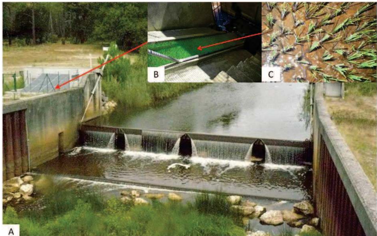
Figure 11) Ecluse du Pas du Bouc (A), avec son échelle à civelles (B) et le substrat utilisé (C) (©FDAAPPMA 33).
