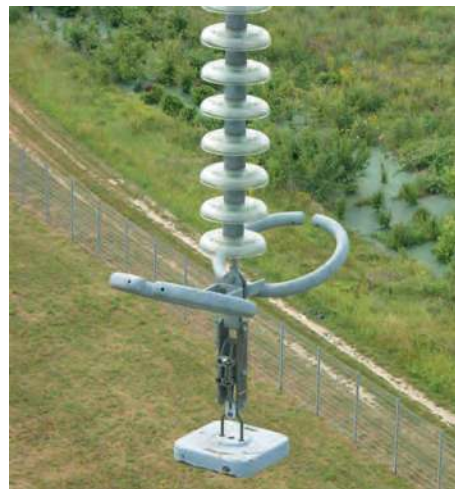
figure 19 Vue de l'isolateur.
