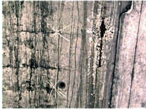
figure 3 a : éclatement de béton avec armature verticale apparente corrodée, vraisemblablement dû à une insuffisance d'enrobage b : visualisation de deux clés d'assemblage des voussoirs c : exemples de défauts relevés.
