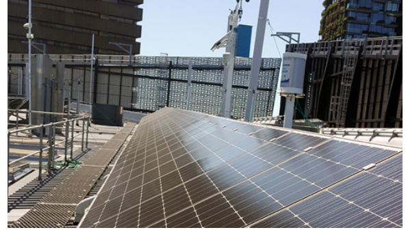
(b) PV array
