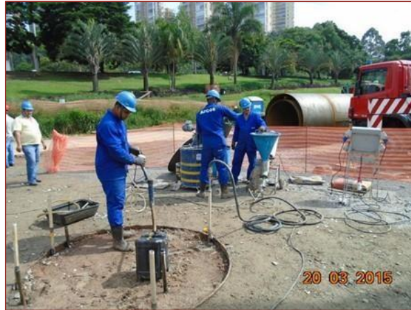
Figura 15. Injeção da calda de cimento na estaca após o término do ensaio.
