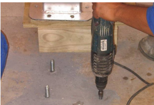
Figura 7.20 – Colocação de chumbadores para a fixação dos montantes da laje de apoio.
