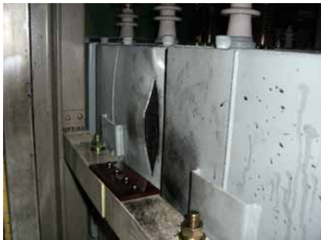
写真1 DTL-PLT電源内コンデンサ破損
