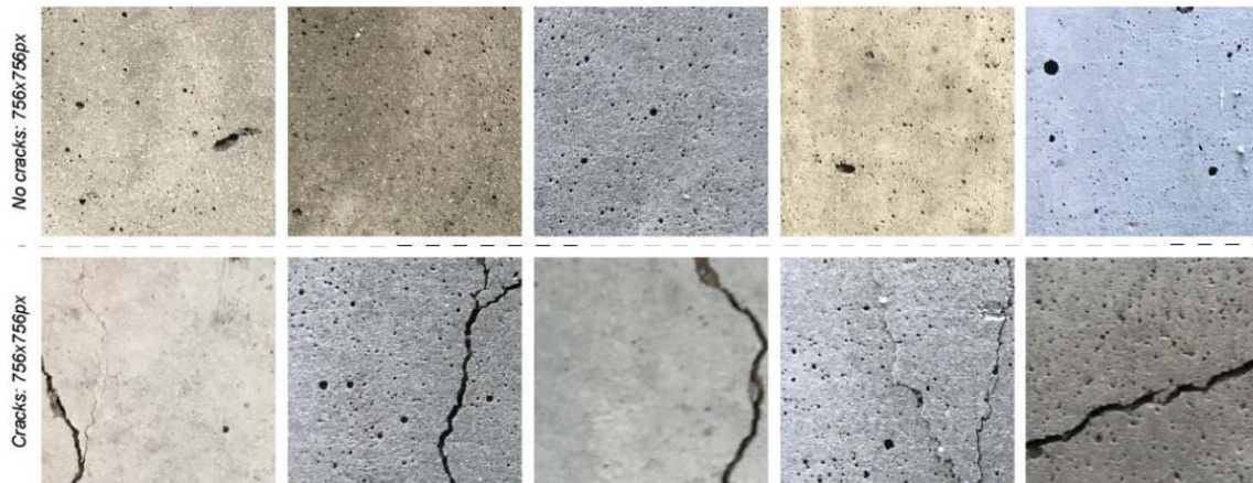
Figura 2 - Exemplo das imagens com e sem fissuras ou trincas que compõem o dataset
