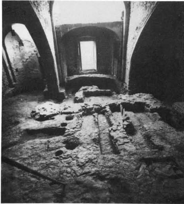
Antes de la actuación arquitectónica, hay que garantizar la extracción de toda la información que se acumula en el monumento y que puede perderse. Sant Vicenç de Malla. Arqueólogo: Alberto López. Foto: Joan Francés.
