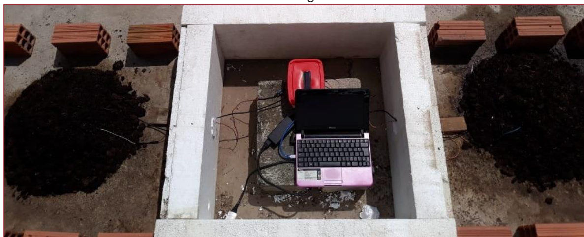
Imagem 6 – Sistema de Monitoramento de Temperatura e Umidade montado no Sistema de Tratamento de Resíduos Orgânicos
