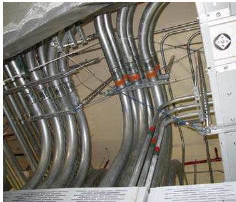
(a) Electrical Conduits
