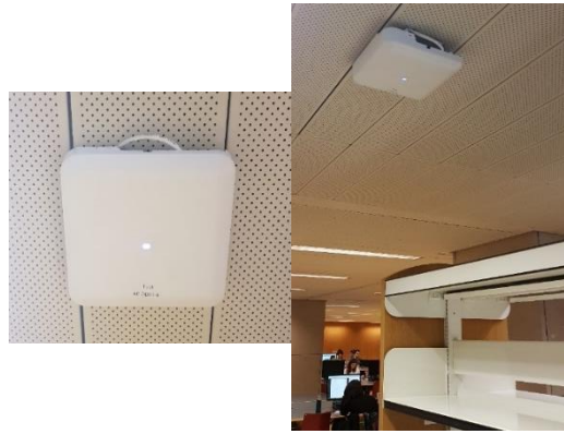
Abb. 6.3: Access Point der TU Wien
