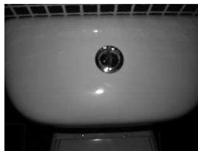
Figure 6. Double flush toilets (6/3 l).
