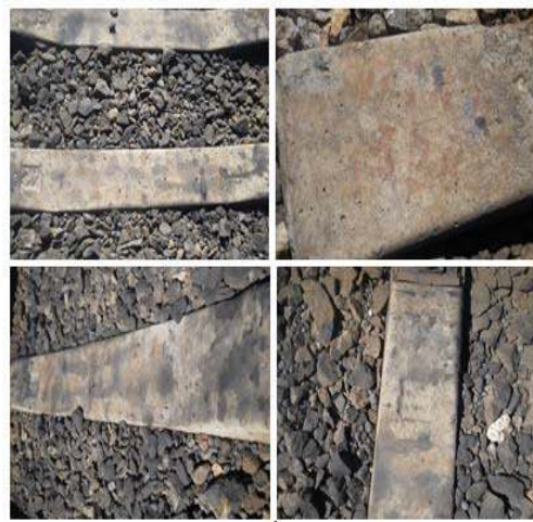
Рис. 12. Формування корозійних каверн в забрудненому бетоні шпал
