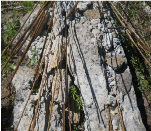
Рис. 13. Кінцевий стан бетону впродовж періоду менше ніж 3 роки експлуатації
