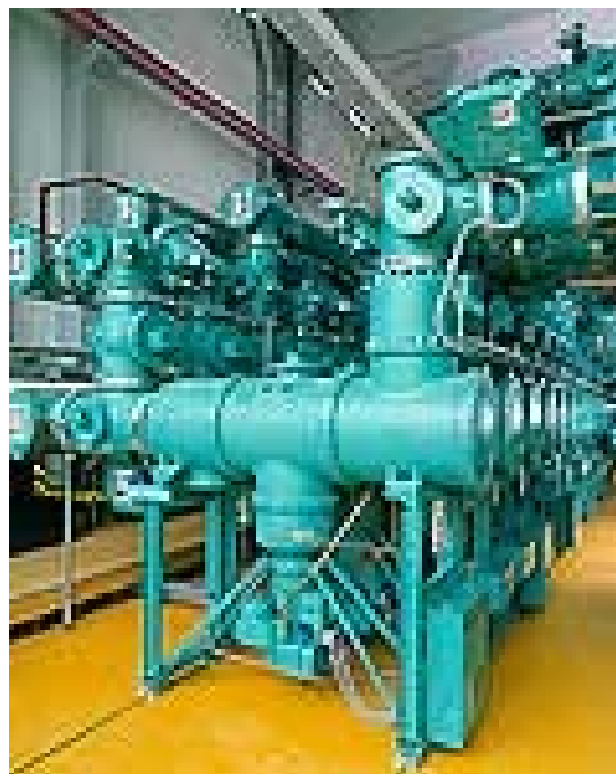
Figura 4.4 – Foto de SE GIS – KN0BRA0103 138 kV – Fonte: www.siemens.com.br
