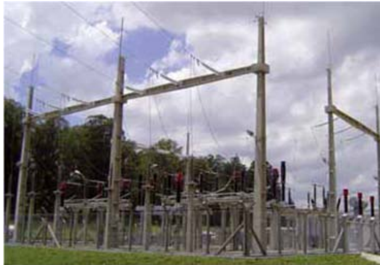
Figura 4.1 – Foto de SE convencional Nestlé S.A. – Araras – SP – SE 138 kV - 20 MVA
