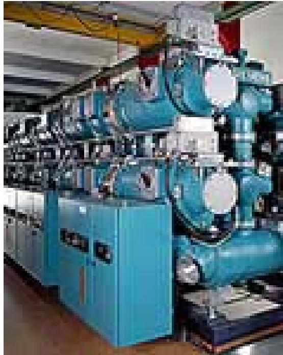
Figura 4.3 – Foto de SE GIS – GIS8DN9 245kV – Fonte: www.siemens.com.br
