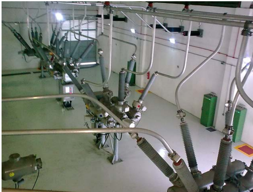
Figura 4.5 – Foto de SE Híbrida – SE Itaim – 138-13,8 kV – 120 MVA – Módulo de AT isolado à SF 6
