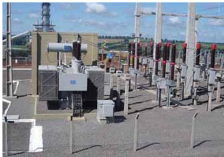
Figura 4.2 – Foto de SE convencional US Santa Terezinha – Tapejara – PR SE 138-13,8 kV – 62,5 MVA – Fonte: www.weg.com.br
