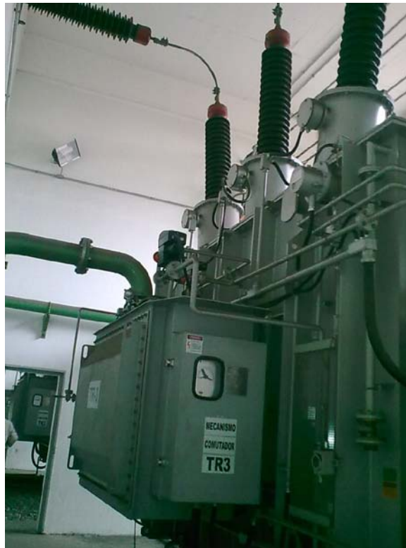
Figura 4.6 – Foto de SE Híbrida – SE Itaim – 138-13,8 kV – 120 MVA – Transformadores convencionais abrigados
