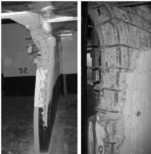
Figure 1 – Out-of-plane buckling of walls after 2010 Chile earthquake / Instabilità fuori dal piano delle pareti in seguito al sisma del 2010 in Cile (Wallace 2012)
